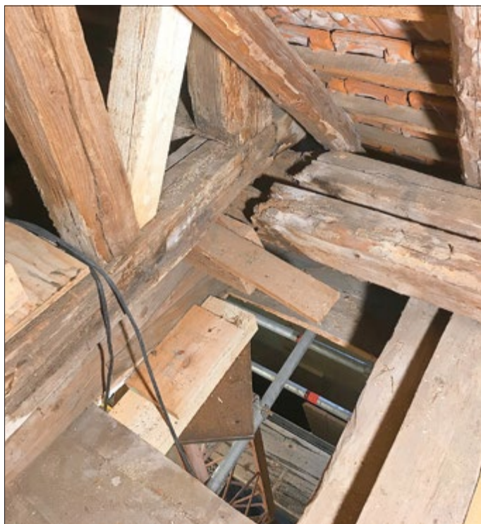
Durch eindringende Feuchtigkeit im Zeitraum von ungefähr zwanzig Jahren wurden die zwei tragenden Balken am südwestlichen Turmfuß zerstört Foto: C. Reißig
