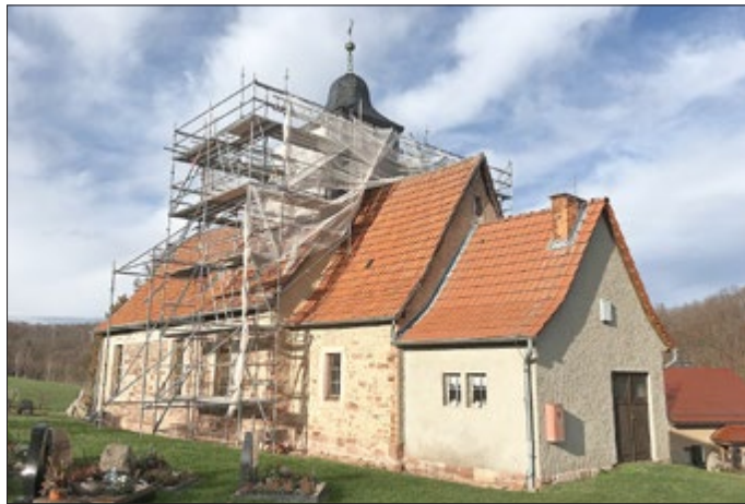
Seit 10. Januar steht der Kirchturm wieder auf sicheren Füßen und im Lot – tolle Leistung der Handwerker der Firma Bennert-Foto: C. Reißig
