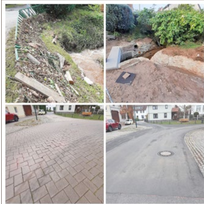
Durchlass Waldbadstraße/Langetal und Hauptstraße Farnroda
